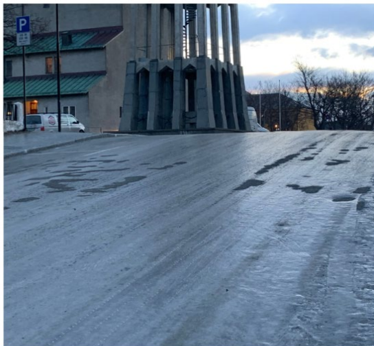
78 prosent av de som ermed i undersøkelsen sier at de unngår områder som ikke er brøytet eller strødd. Slik så det ut i i Professor Schyttes gate en vinterdag i 2021. Foto: Pål Guttormsen
